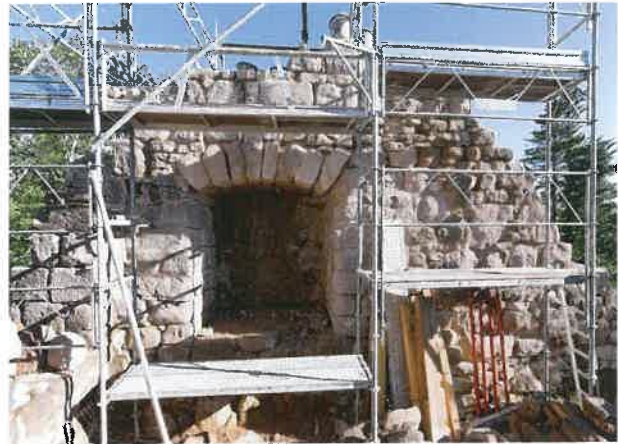
Fig. 15B Château de Kagenfels - La niche d'archère est du logis remontée (Photo Mathias Heissler)
