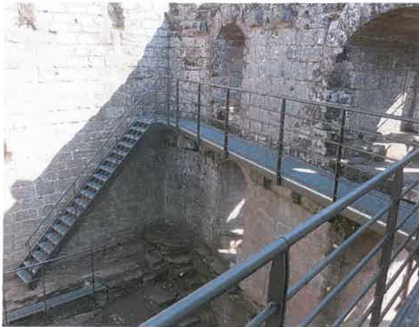
Fig. 18 Château de Nouveau-Windstein - L'Accès au second étage du logis (Photo Alain Kieber)
