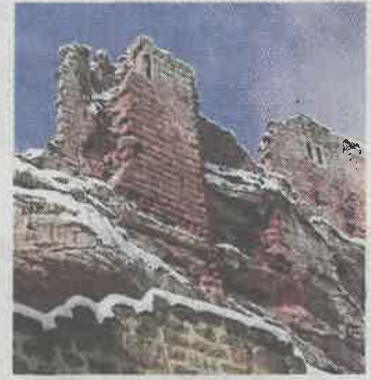
Le pan de mur du logis nord avant sa consolidation en 2014. DOCUMENT REMIS
